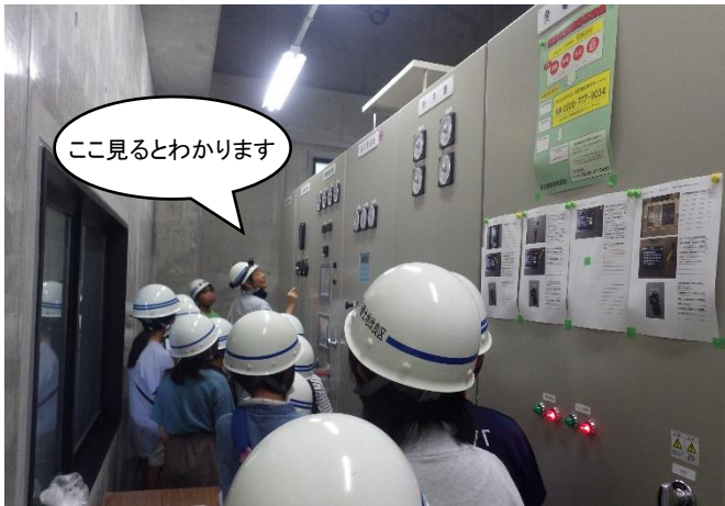
水窪ダム発電所内部見学
